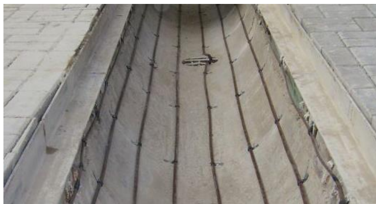
Рис. 3а – Пример устройства защиты лотка от обледенения.
